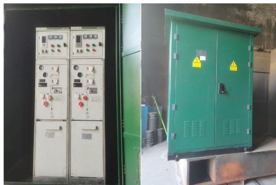
ExMRMW-AIRI01-12 户外开闭所
